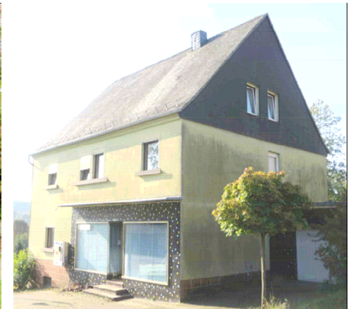
Abb. 4.4.1b: Betriebs- und Wohngebäude mit mittleren Sanierungsbedarf, dessen Versorgungsfunktion durch den Leerstand für den Ort gleichzeitig verloren ist.
