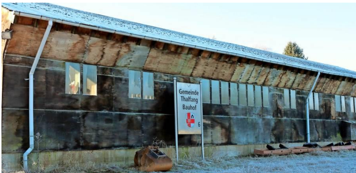
Auch ein Projekt für die nahe Zukunft: Das Dach der Bauhofhalle 1 in Thalfang muss dringend erneuert werden. Foto: Herbert Thormeyer
