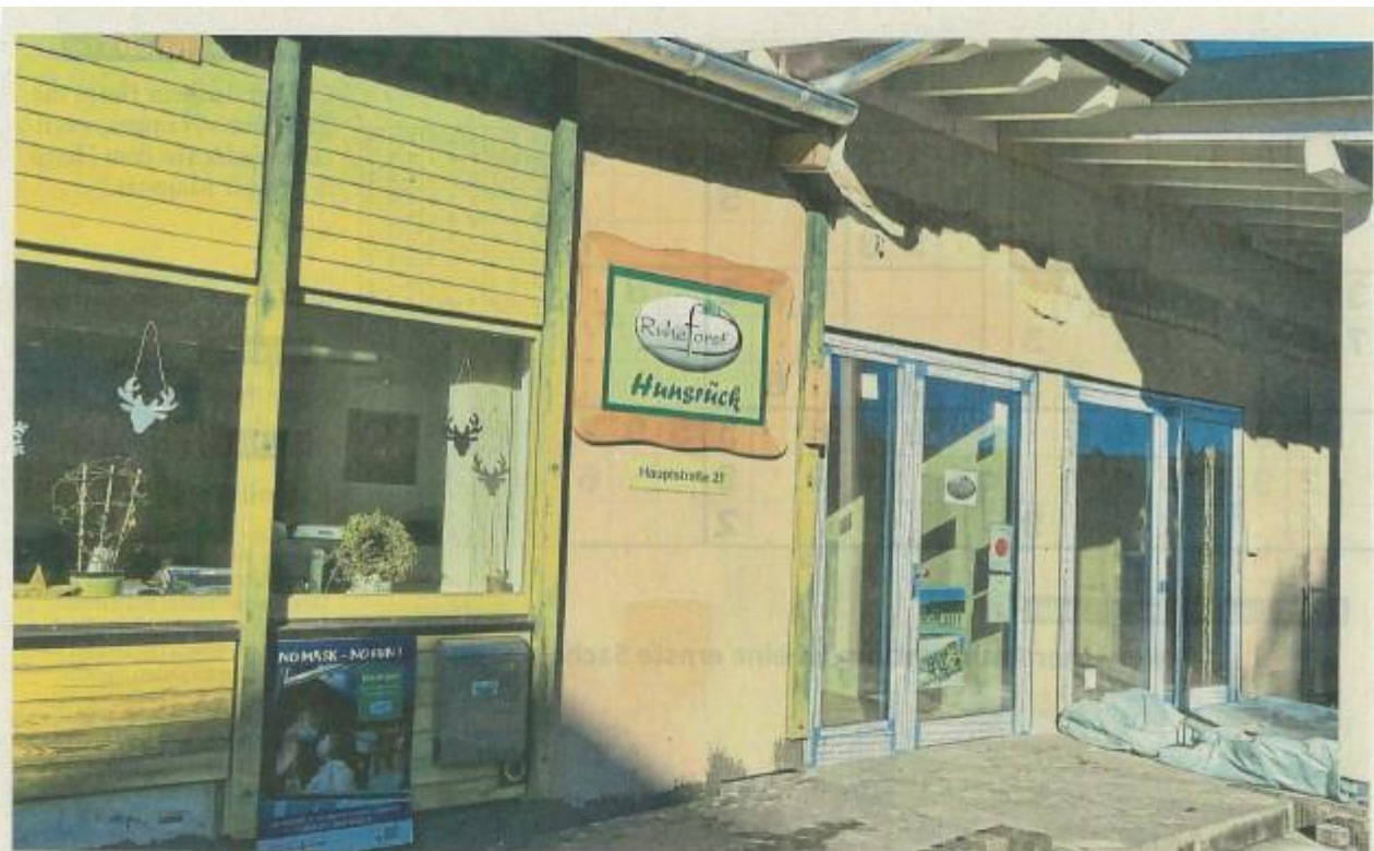
Im einstigen Raiffeisen-Gebäude in der Hauptstraße 21 hat bereits die Geschäftsstelle des Ruheforsts ein Domizil gefunden. Ein weiterer Gebäudeteil wird derzeit zur Hildegard-Begegnungsstätte ausgebaut.
