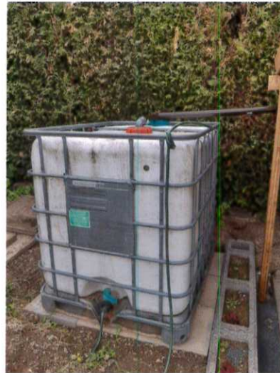
Anschluss altes Wasser- fass an Regenrinne des Gartenhauses
